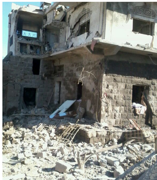
Photo fournie par un interviewé de son logement en ruine, suite à une attaque par bombe barril.
